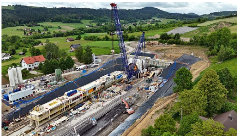
Plac budowy na granicy Męciny i Pisarzowej, w miejscu drażenia tuneli, fot. Piotr Hamarnik
